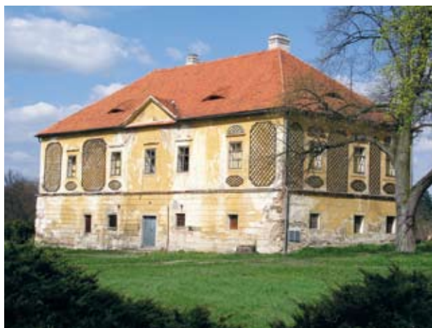
Obr. 2. Horšovský Týn, zámek. Tzv. Vdovský dům nebo také Muzeum (podle posledního využití) v zámeckém parku. Budova renesančního původu je již řadu let bez využití a chátrá. Využití brání špatný stavební stav a absence přípojek inženýrských sítí. (Foto M. Solař, 2004)
