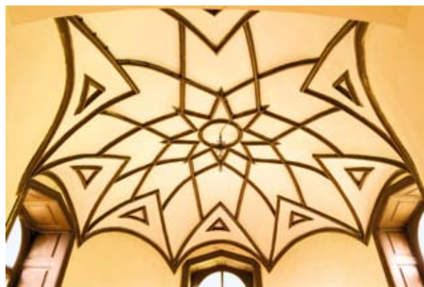
Obr. 16. Nalžovské Hory, zámek. Klenba v patře jednoho z rondelů. (Foto R. Kodera, 2011)
