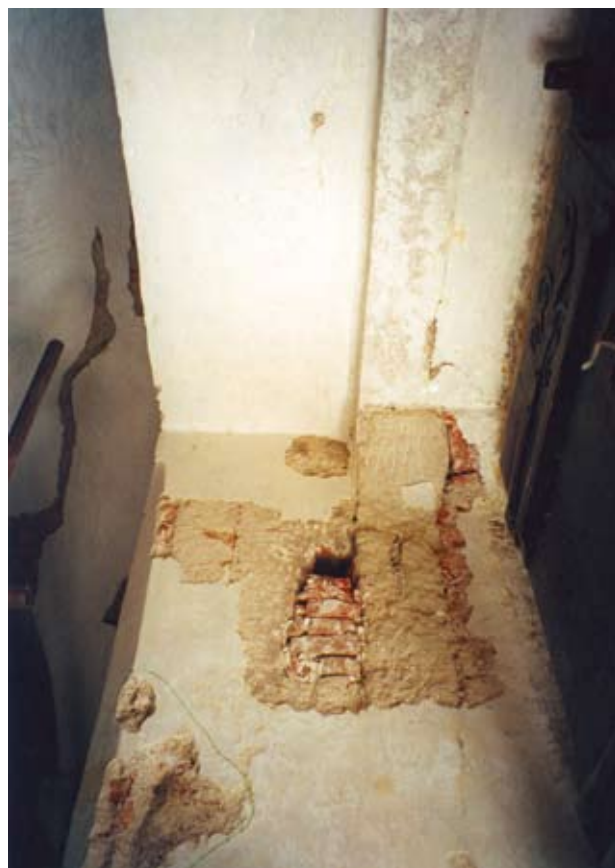
Obr. 3. Plasy, kostel Nanebevzetí Panny Marie. Jižní špaleta západního portálu s odsekanou románskou stojinou ostění pod tympanonem. Pohled vzhůru. (Foto Z. Chudárek, 2007)
