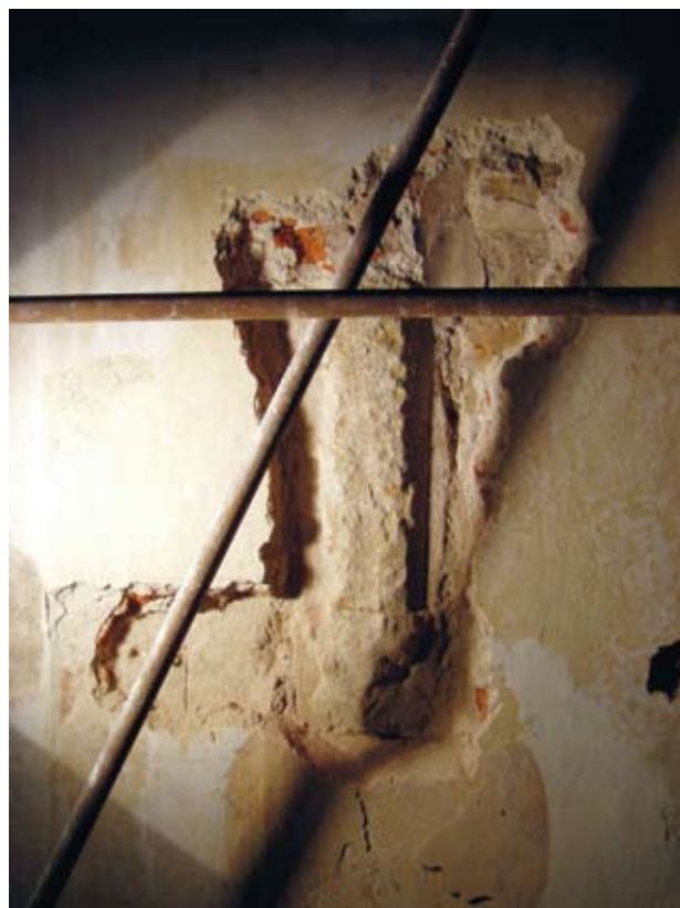
Obr. 6. Plasy, kostel Nanebevzetí Panny Marie. Odsekaná gotická konzola (S9) a krácená přípora. Vpravo nahoře fragment románské římsy pod zaniklou klenební patkou. Na římsě fragment románské omítky, zleva přetažen gotickou kletovanou omítkou. (Foto Z. Chudárek, 2009)
