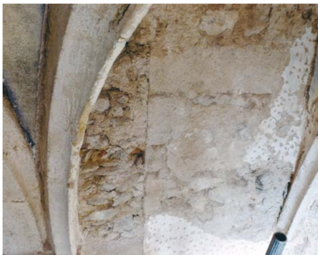
Obr. 6. Staré Sedlo, kostel Nanebevzetí Panny Marie. Spára zjištěná ve zdivu severního pole závěru sakristie, v ploše čelního oblouku paprscité žebrové klenby. (Foto P. Novák, 3/2012)
