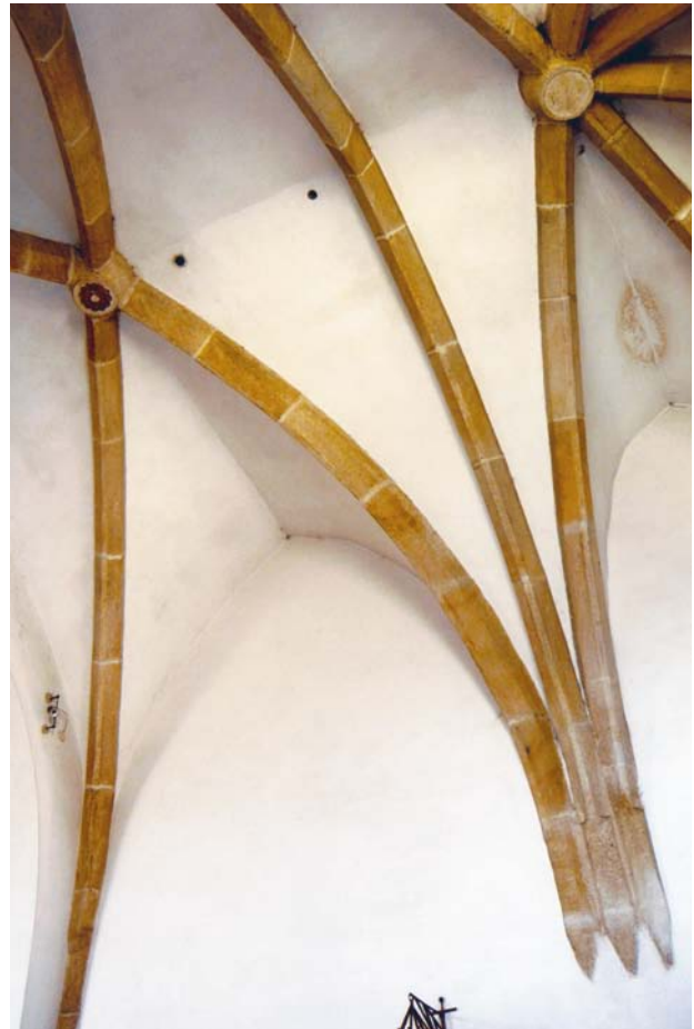
Obr. 24. Staňkov (okr. Domažlice), kostel sv. Jakuba Většího. Pohled do severozápadní části kleneb v presbyteriu s potrojným výběhem klenebních žebér na rozhraní křížové klenby a klenby paprscité. (Foto J. Kaigl, 2008)
