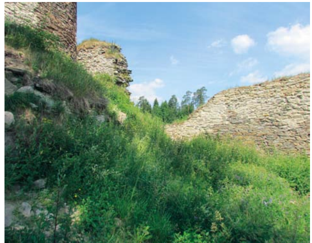
Obr. 23. Okrouhlé Hradiště, zřícenina hradu Gutštejna. Severní hradba východní části hradního jádra, pohled od jihovýchodu. Stav po opravě (nové vyzdění proluky, přezdění koruny, spárování, položení drnů). (Foto P. Sokol, 2012)
