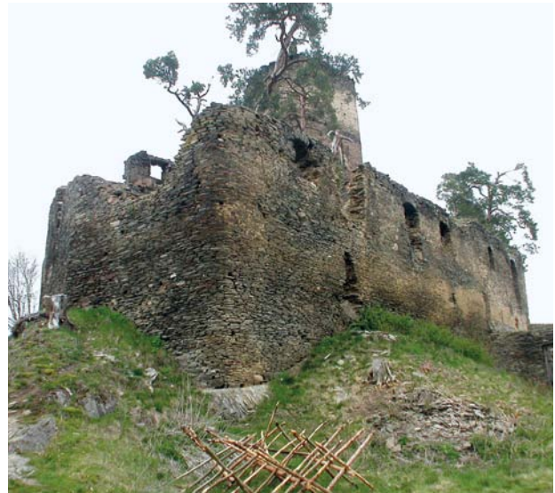
Obr. 5. Okrouhlé Hradiště, zřícenina hradu Gutštejna. Jižní palác, pohled od jihozápadu. Stav před opravou. (Foto P. Sokol, 2006)
