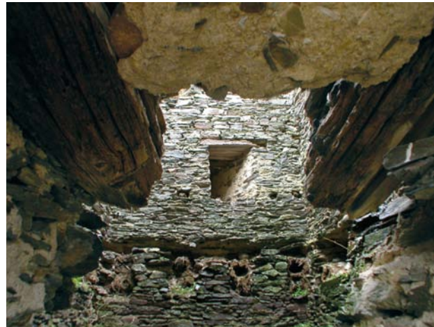
Obr. 26. Okrouhlé Hradiště, zřícenina hradu Gutštejna. Věž, pohled z dodatečně proraženého vstupního otvoru na západní straně. Zbytky trámového roštu z 20. let 15. století a okénko s dřevěným překladem z 80. let 15. století. (Foto P. Sokol, 2010)
