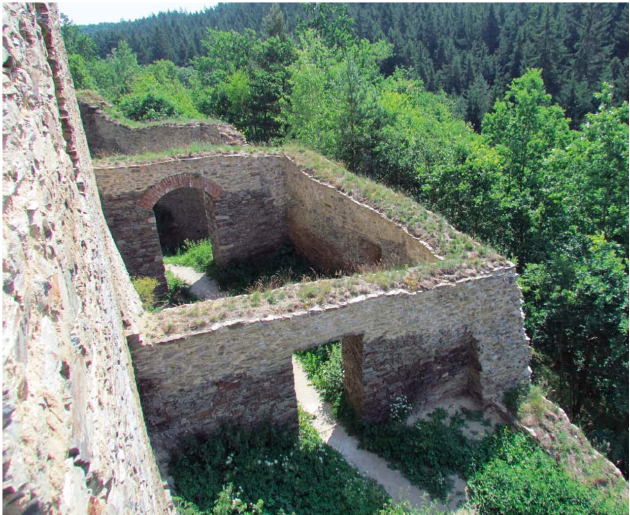
Obr. 17. Okrouhlé Hradiště, zřícenina hradu Gutštejna. Stavění v jižním parkánu, pohled z jižního paláce od severozápadu. Stav po opravě. (Foto P. Sokol, 2012)
