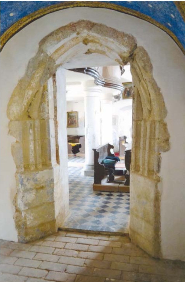
Obr. 10. Blížešov, kostel sv. Martina. Portál v jižní kapli (kdysi vstupní předsíni) do chrámové lodi. (Foto J. Kaigl, 2012)
