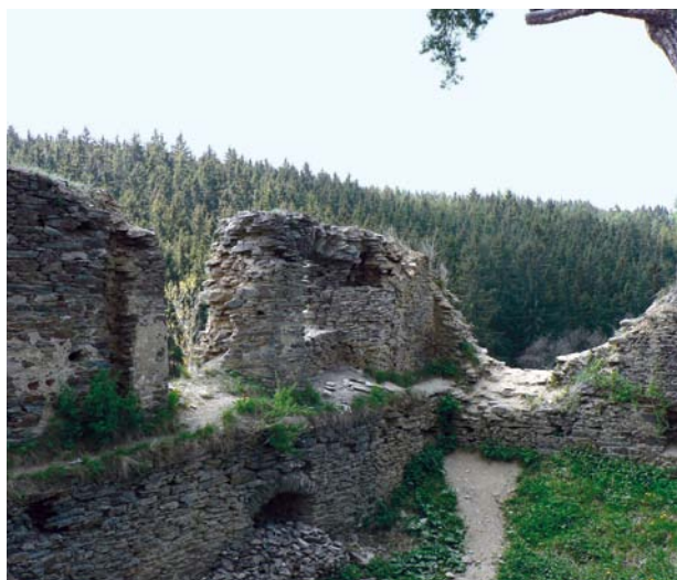
Obr. 3. Okrouhlé Hradiště, zřícenina hradu Gutštejna. Západní část jižního paláce, pohled od severovýchodu. Stav před opravou. (Foto T. Karel, 2006)
