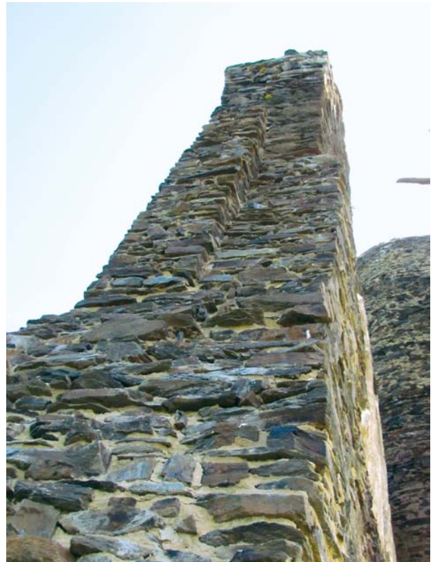
Obr. 12. Okrouhlé Hradiště, zřícenina hradu Gutštejna. Severní stěna severního paláce, pohled od západu. Stav po opravě doplněním přízdívky se snahou o rozlišení vývoje zdiva. Projekt předpokládal přízdívku na způsob opěráku se zarovnanými šikmými plochami ve dvou úrovních ve střední části (naznačení druhotného zesílení); dodatečnou opravou odstraněna líčová plocha a naznačeno neukončené zdivo. (Foto P. Sokol, 2012)
