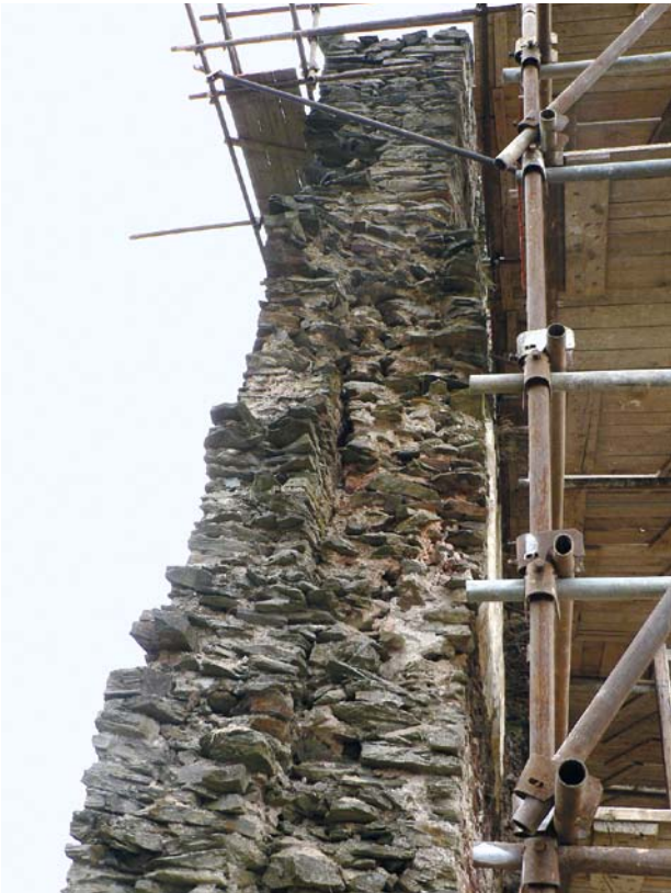
Obr. 11. Okrouhlé Hradiště, zřícenina hradu Gutštejna. Severní stěna severního paláce, pohled od západu. Stav před opravou. Patrné je dodatečné zesílení a navýšení zdi v důsledku pozdější výstavby paláce. (Foto L. Havlovic, 2010)
