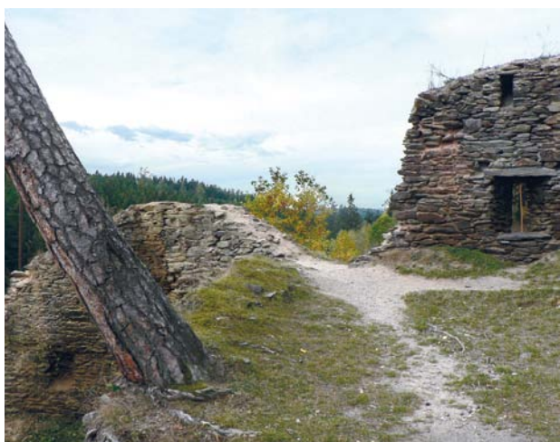
Obr. 9. Okrouhlé Hradiště, zřícenina hradu Gutštejna. Západní zeď horního nádvoří, pohled od východu. Stav před opravou. (Foto L. Havlovic, 2009)
