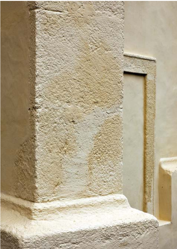
Obr. 5. Bukovec, kostel Nanebevzetí Panny Marie. Detail nové barevnosti fasád presbyteria – omítaných ploch a prvků architektury z tesaného kamene. (Foto L. Sommer, 2005)
